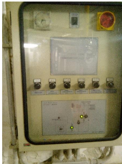
Figura 4.9 – Quadro di regolazione impianto.
