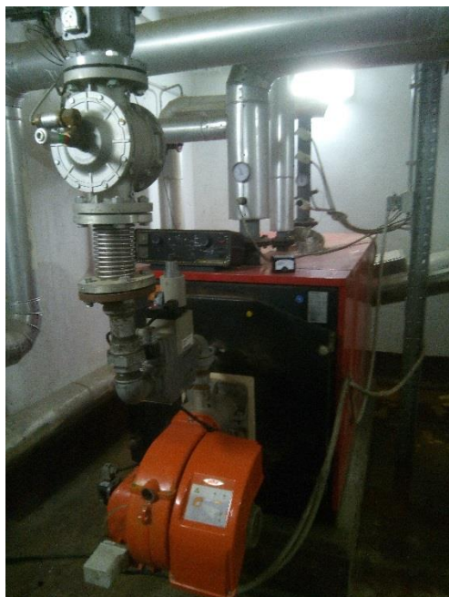
Figura 4.12 – Particolare del generatore di calore a basamento e del relativo bruciatore.
