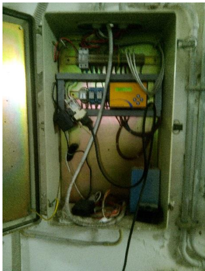
Figura 4.8 – Quadro sistema di telegestione
