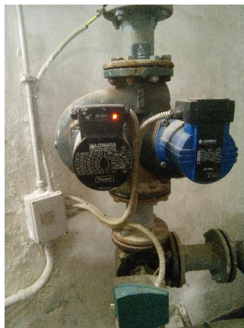
Figura 4.13 - Particolare della pompa gemellare per la distribuzione dell'acqua calda per il riscaldamento.
