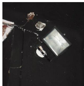
Figura 4.16 - Particolare dei faretti alogeni
