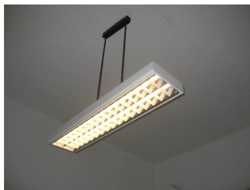
Figura 4.15 - Particolare dei corpi illuminanti a fluorescenza tipo T8 2x36W
